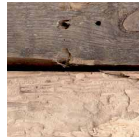
Schade van de huisboktor. Kenmerkend zijn de ovale uitvliegopeningen met een grootste middellijn van 6 tot 10 mm (boven) en talrijke, ovale boorgangen binnenin het hout (onder) (foto Uwe Noldt)
