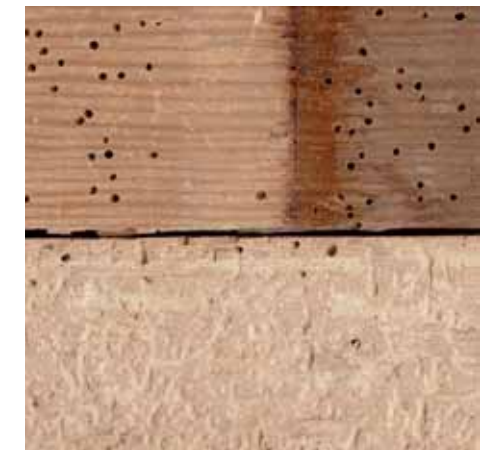
Schade van de gewone houtwormkever. Kenmerkend zijn de ronde uitvliegopeningen met een diameter van 1 tot 2 mm (boven) en talrijke, ronde boorgangen binnenin het hout (onder) (foto Uwe Noldt)
